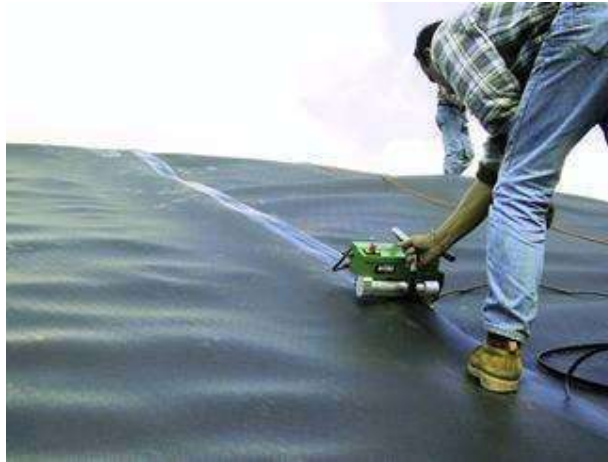
Imagen 5. Detalle de soldadura de la membrana. Fuente. Municipalidad de Tandil
