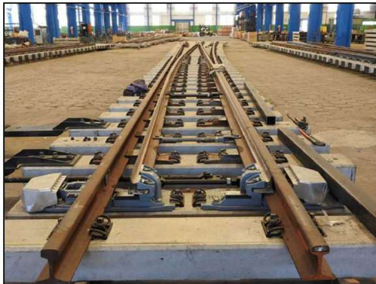
Fotografía 4. Aparato de vía
