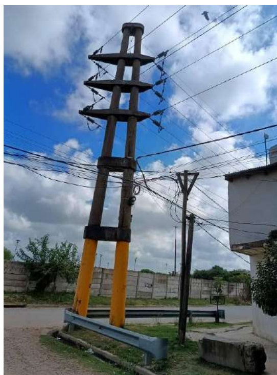
Figura 3.61 Línea aérea en la esquina de calle 32 y calle J.B. Justo.
