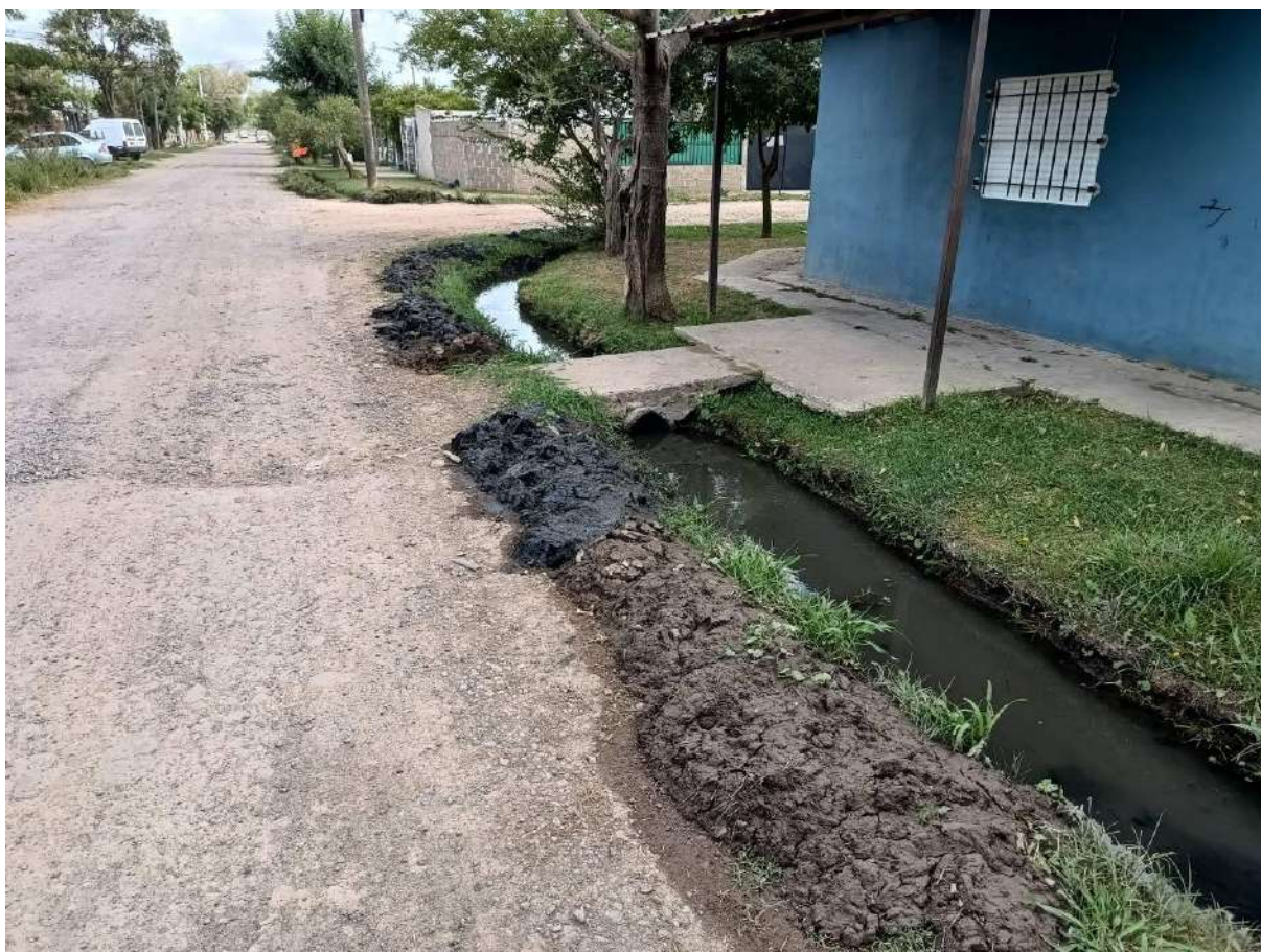
Figura 3.22 Estado de zanjas pluviales próximas a la cabecera del proyecto: aguas estancadas y eutrofizadas.
