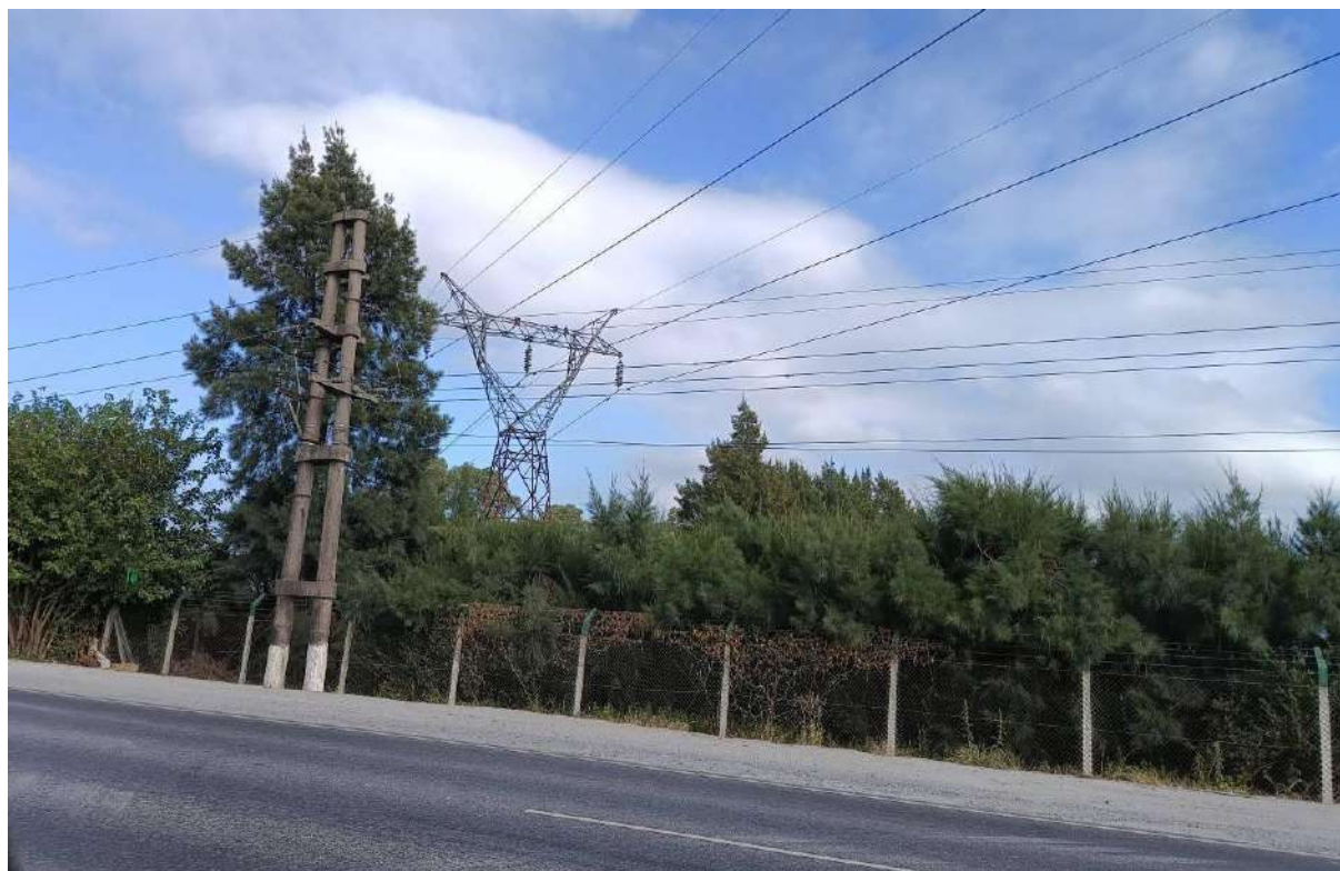
Figura 3.28 Cruce de la LAT ILSZA1 sobre el camino de acceso industrial.
