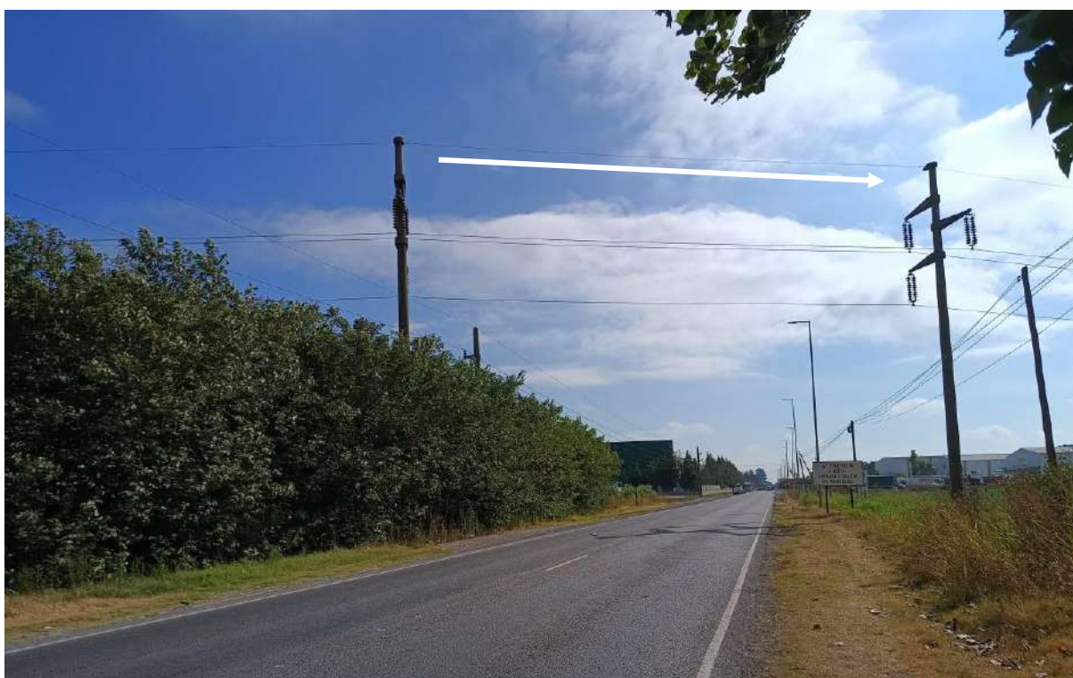
Figura 3.30 Cruce de la LAT 1ATZA1 sobre el camino de acceso industrial. A la derecha se aprecia el piquete 14.
