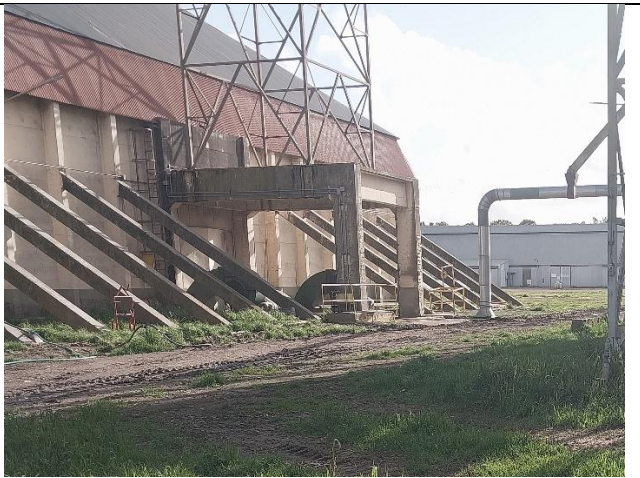
Equipo de aireación de la celda
