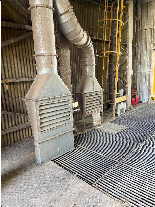
Sistema de Aspiración
