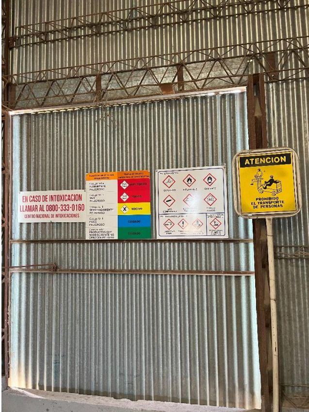
Cartelería en depósito de agroquímicos
