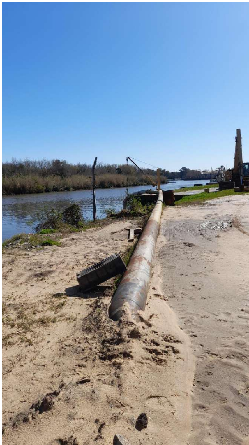
Imagen correspondiente a la cañería de descarga que extrae la arena desde los barcos
