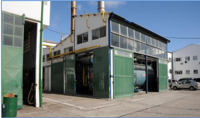
SALA DE CALDERAS
