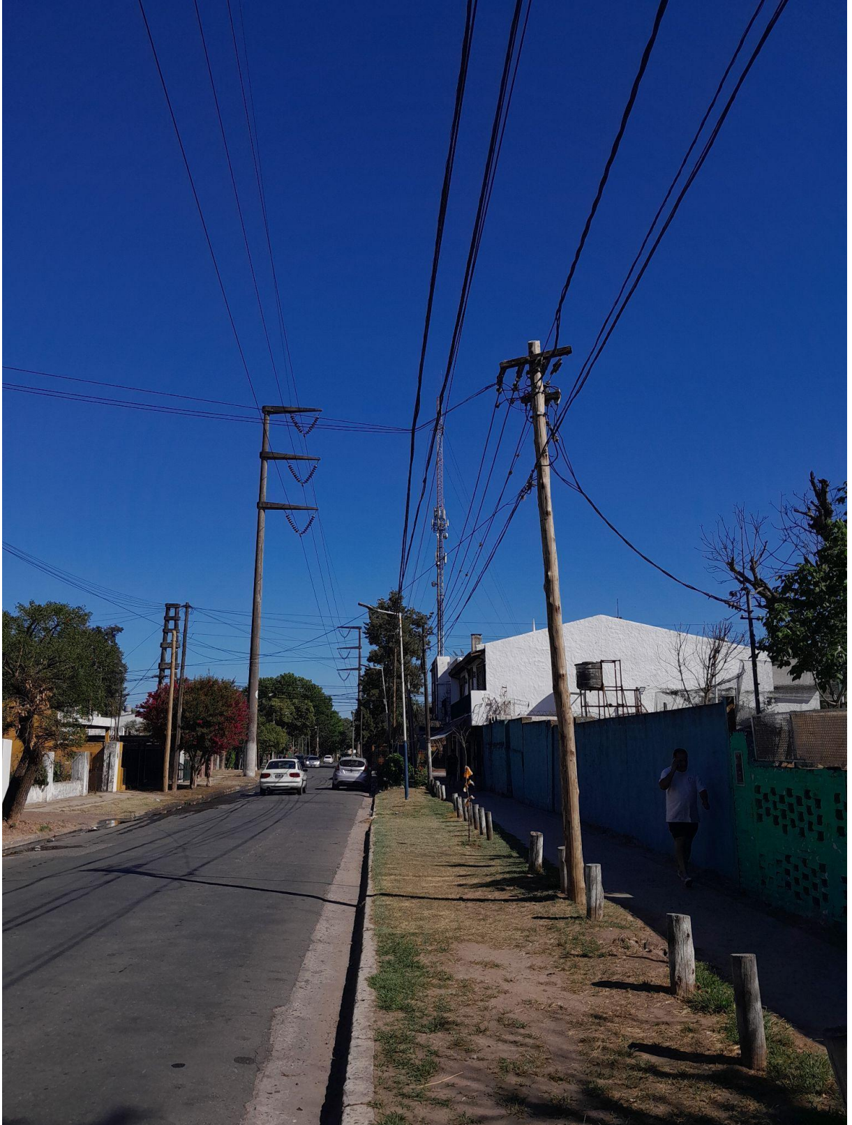
Figura 4.24. Red de tendido eléctrico en Calle Misiones entre Los Nogales y Los Caldenes dentro del área operativa. Imagen propia tomada por el DEAS-DPH. Enero 2023.
