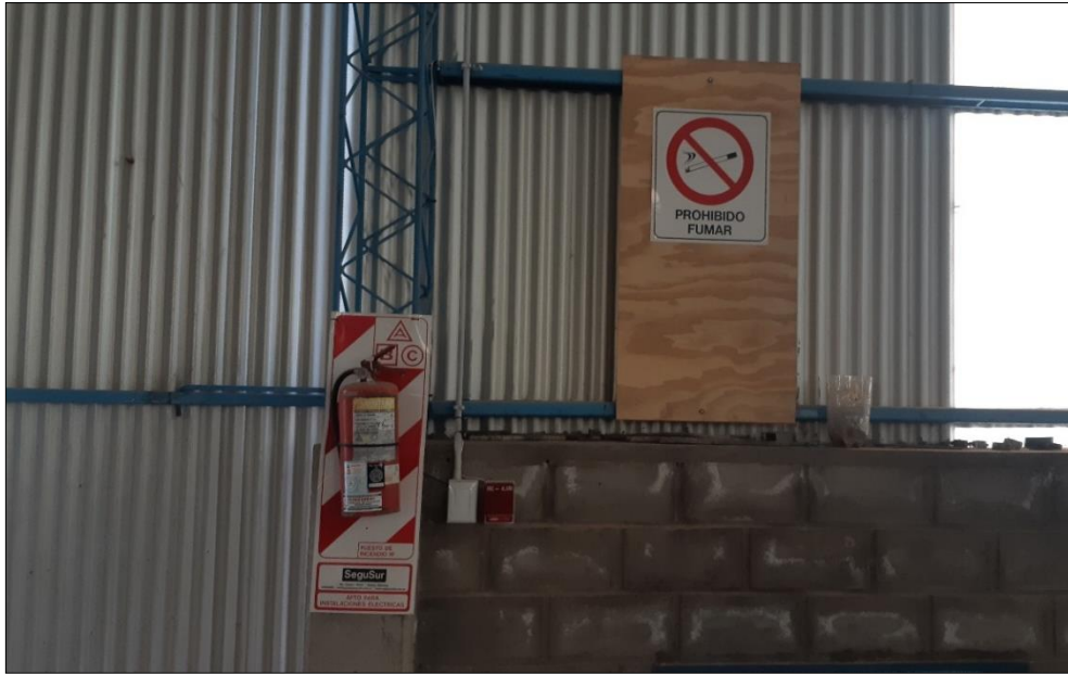
Imagen 45: Matafuego en depósito y carteles de señalización.
