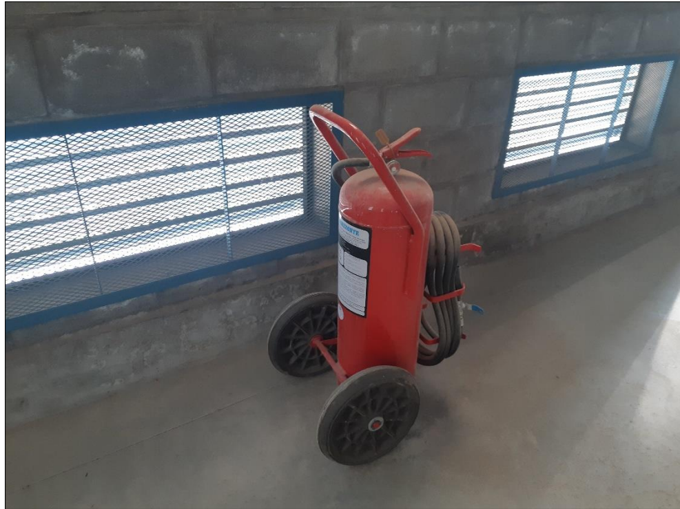
Imagen 47: Matafuego en depósito y carteles de señalización.
