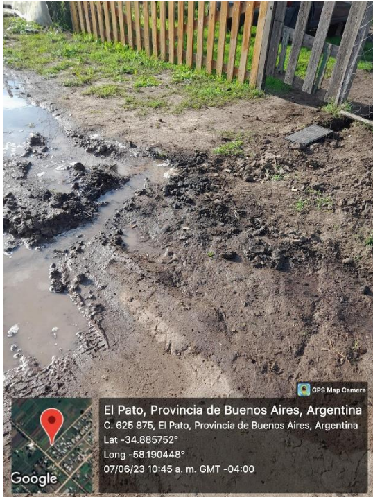
Figura N° 27: Calle 510 Pérdida de agua en un domicilio
