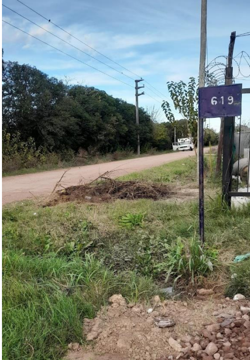
Figura N° 21: Calle 619 y 517. Los materiales de trabajo obstruyen los vuelcos.
