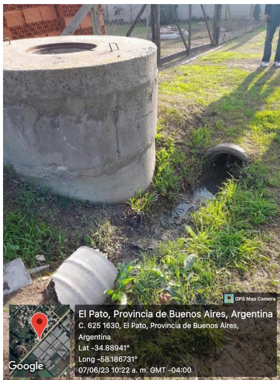
Figura N° 25: Calle 517 con algunos caños para contención de vuelcos.
