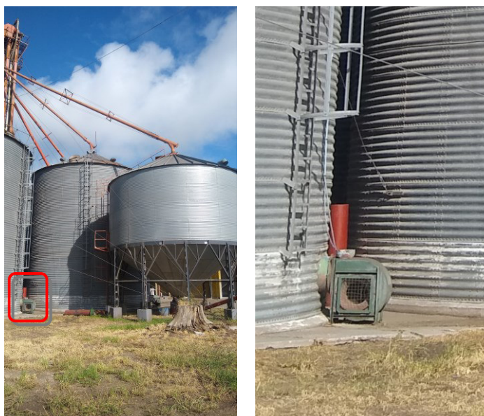
Figura: Vista de ventilador presente en uno de los silos de planta (izquierda) y vista del ventilador en detalle presente en la planta (derecha)
