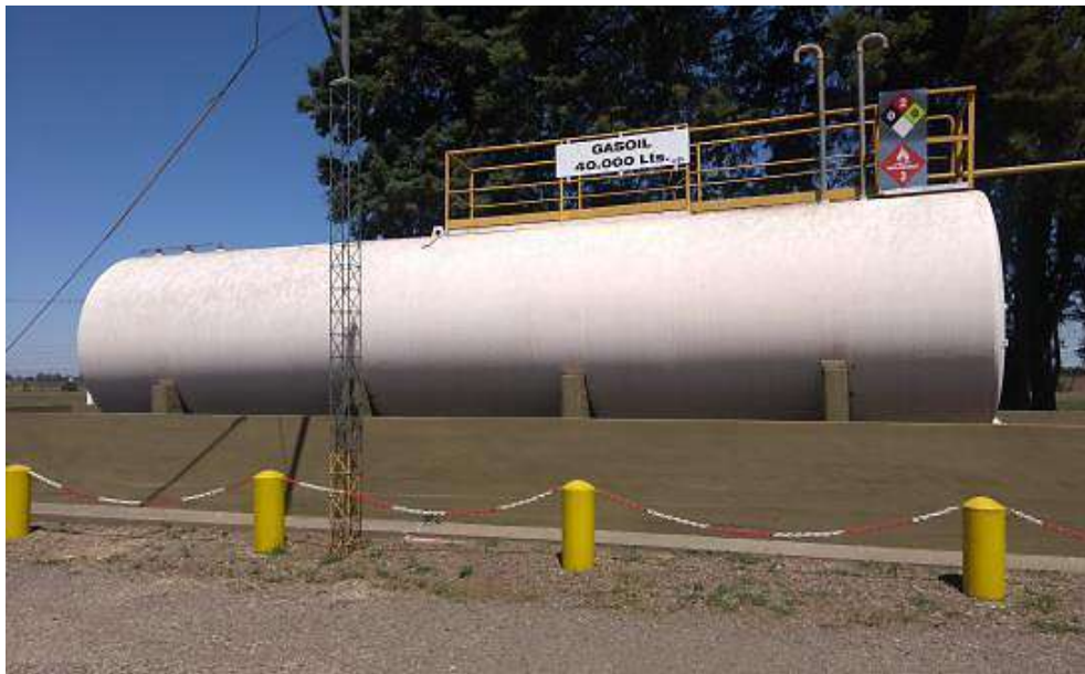
Imagen 16. Tanque de gas oil.
