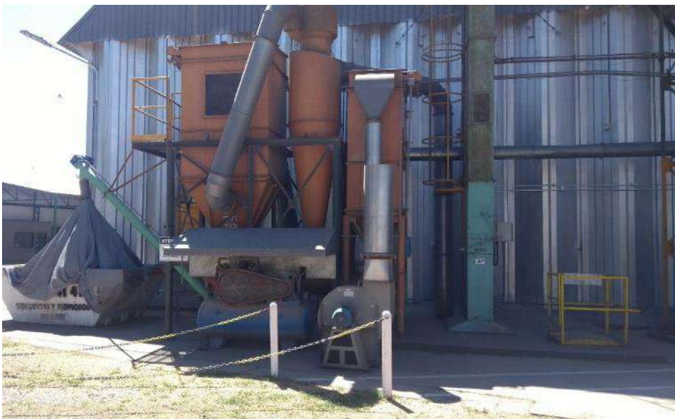
Imagen 13. Sistema de aspiración de la celda.
