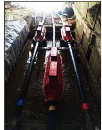
Figura 12. Empalme de Electroducto
