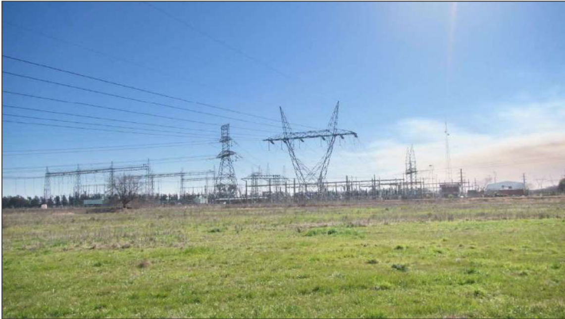
Foto 9. P14 (33°24'47.06"S, 60°10'42.28"O). Alternativa CAS 1 (verde). Acometida a playa de 220 kV en Estación Transformadora Ramallo de Transener. Vista hacia la Estación Transformadora, a 150 m a campo traviesa.
