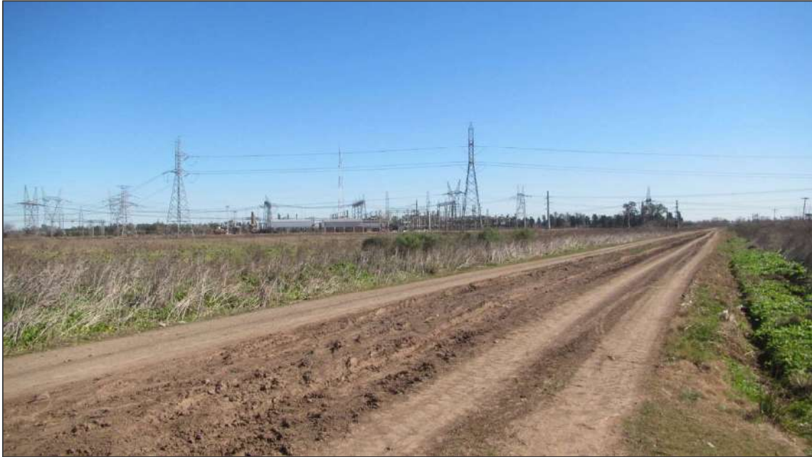
Foto 7. P13 (33°24'38.13"S, 60°10'30.82"O). Alternativa CAS 1 (verde).. Cruce de calle de tierra. Vista hacia la Estación Transformadora Ramallo de Transener.
