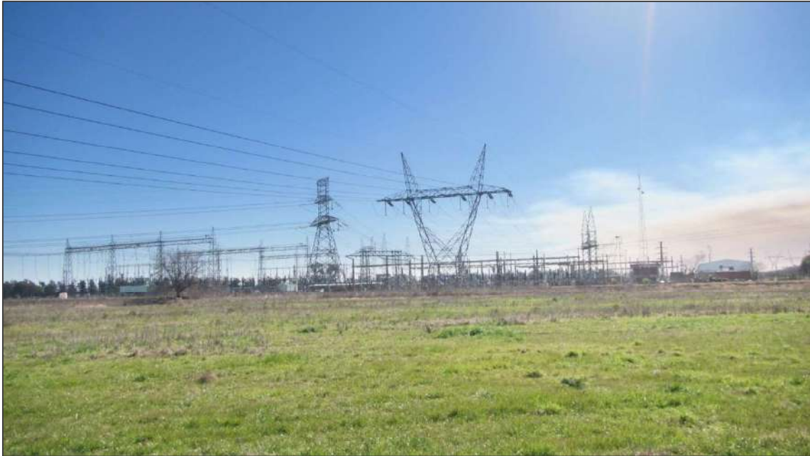
Foto 19. P14 (33°24'47.06"S, 60°10'42.28"O). Alternativa CAS 1 (verde). Acometida a playa de 220 kV en Estación Transformadora Ramallo de Transener. Vista hacia la Estación Transformadora, a 150 m a campo traviesa.
