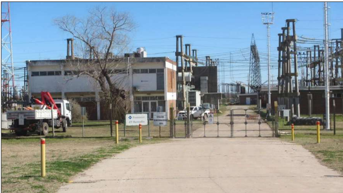
Foto 20. P15 (33°24'36.67"S, 60°10'41.76"O). Portón de acceso a Estación Transformadora Ramallo de Transener.
