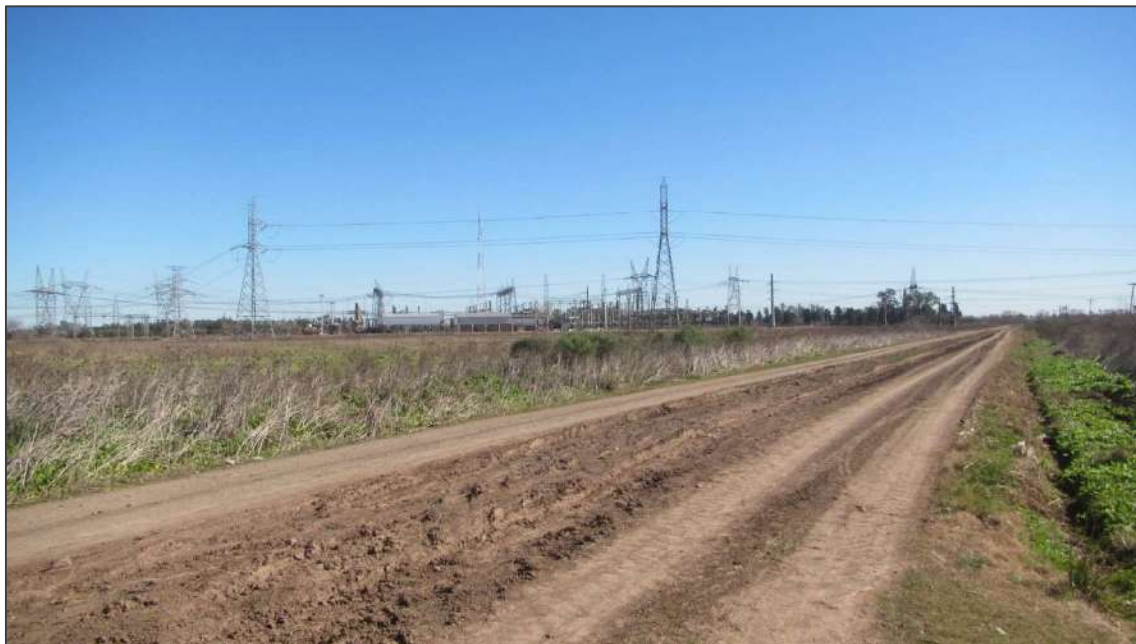
Foto 17. P13 (33°24'38.13"S, 60°10'30.82"O). Alternativa CAS 1 (verde).. Cruce de calle de tierra. Vista hacia la Estación Transformadora Ramallo de Transener.
