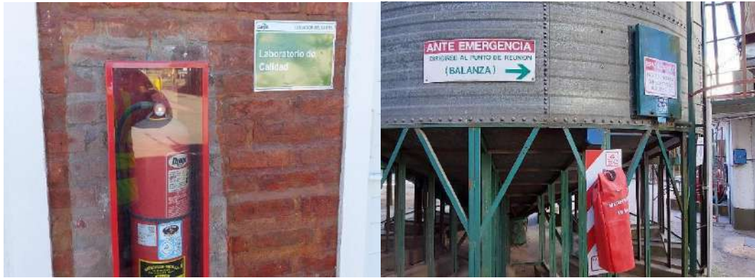
Imagen 11. Vista extintores en planta.
