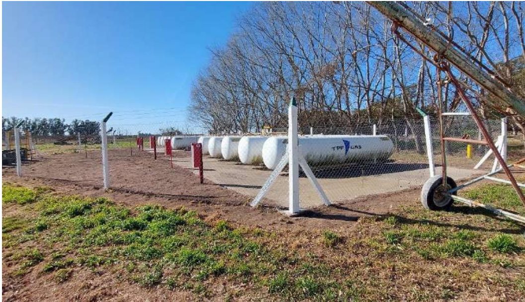
Imagen 04. Tanques de almacenamiento de gas para abastecimiento de secadora.
