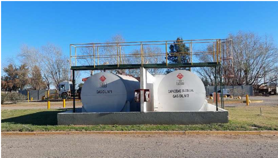
Imagen 12. Almacenamiento de combustible.
