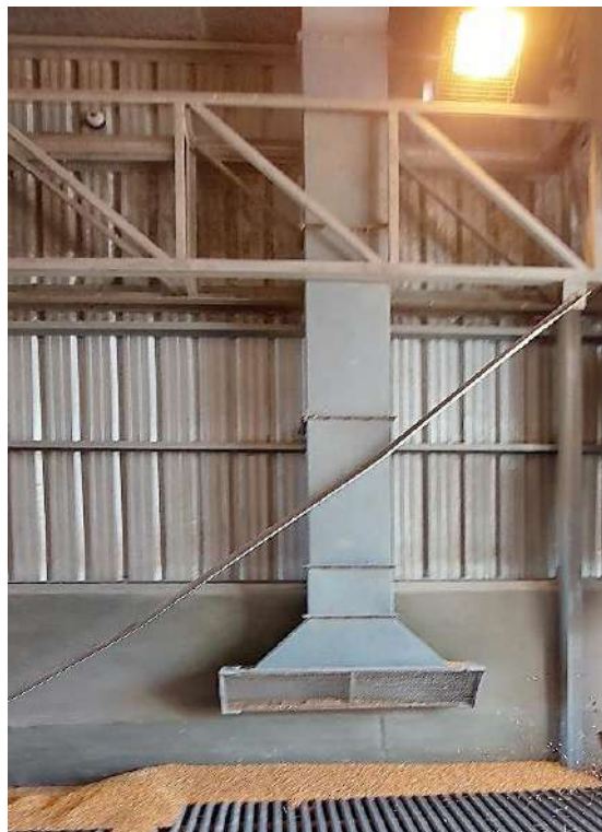
Imagen 08. Sistema de aspiración de polvo.
