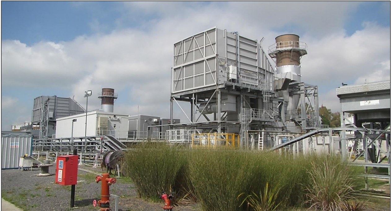
Foto 1. #2. Equipo de generación TG12. En segundo plano, sala de control del TG12 y salas de contenedores eléctricos. Sobre el fondo, toma de aire y chimenea del equipo de generación TG11.
