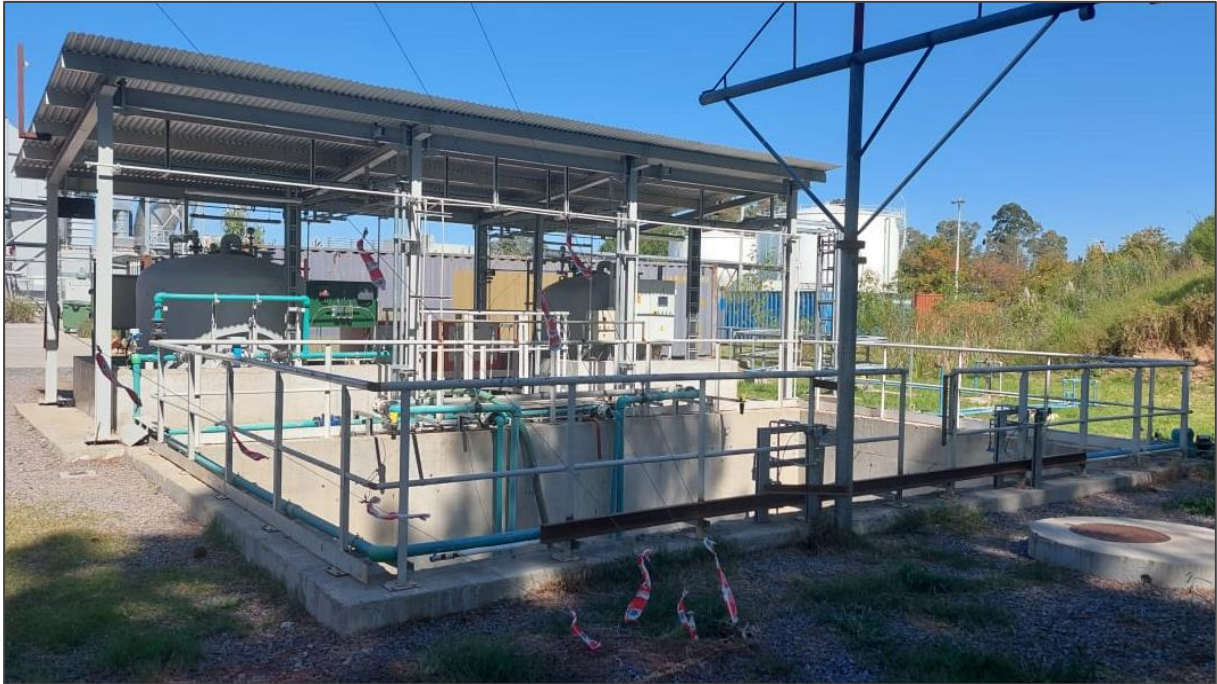
Foto 9. #17. Planta de tratamiento de efluentes
