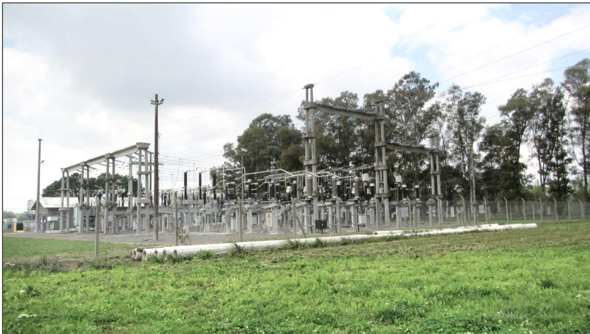
Foto 11. (34°33'31.1"S, 59°02'08.1"O). Estación Transformadora Luján II (TRANSBA SA). Vista de los campos de línea de 132 kV, sitio de acometida de la terna CSAT (Cable Subterráneo de Alta Tensión) proveniente de la Subestación GIS de la Central Termoeléctrica Luján II (Araucaria).
