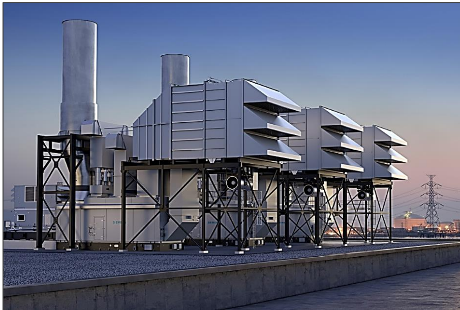
Figura 2.5. Vista del tipo de equipos instalados.
