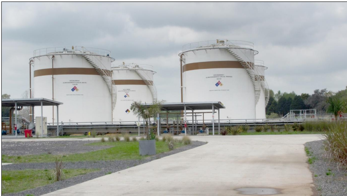
Foto 5. #11. Vista de la Playa de tanques de almacenamiento de gasoil. Sobre la izquierda, los dos tanques de gasoil crudo (1.250 m 3 cada uno); sobre la derecha, los dos tanques de gasoil tratado (900 m 3 cada uno).
