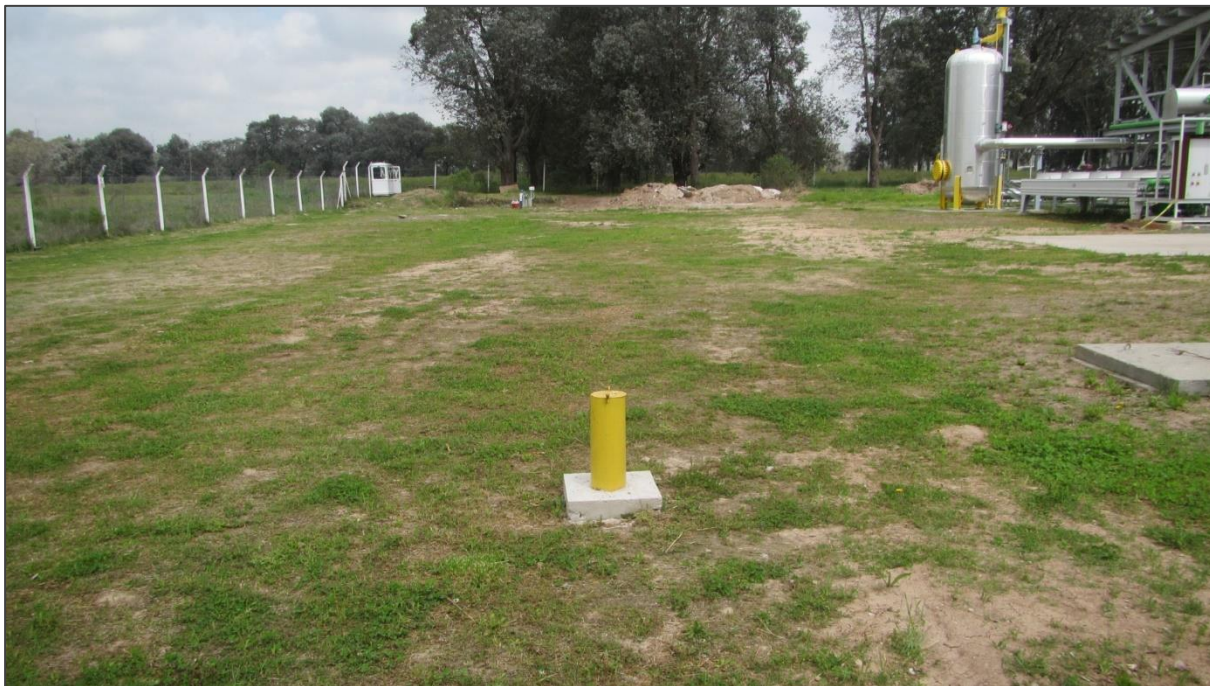
Foto 7. #12. Freatímetro contiguo al recinto de tanques para control de la calidad del agua subterránea. Sobre la izquierda, cerco perimetral del predio y casilla de seguridad.
