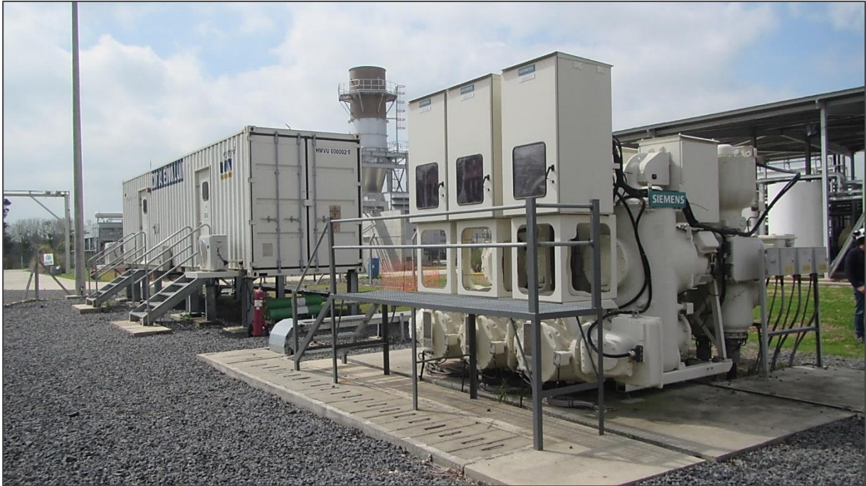
Foto 3. #5. Subestación GIS y la sala de control.
