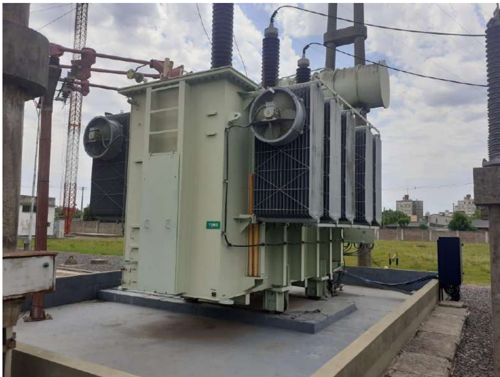
Fotografía 9 – Transformador 2 a reemplazar
