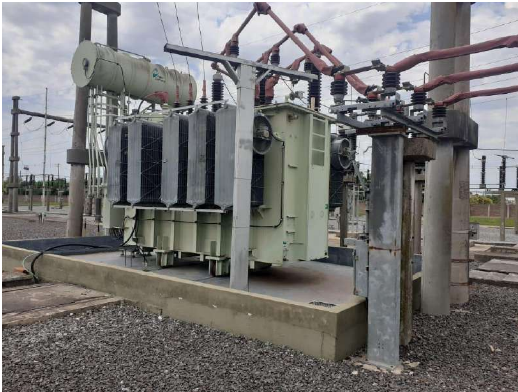
Fotografía 8 – Transformador 1 a reemplazar
