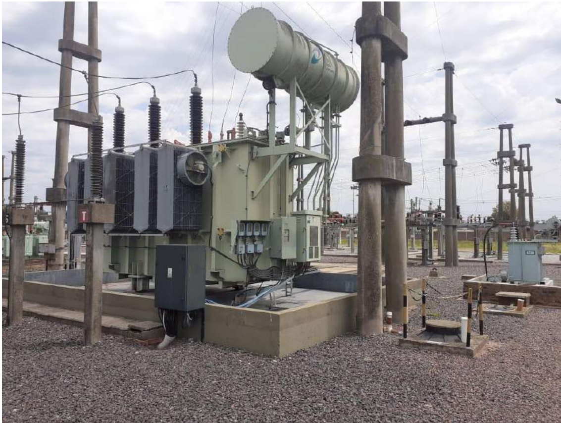
Fotografía 10 – Tr 1 lado 132 kV
