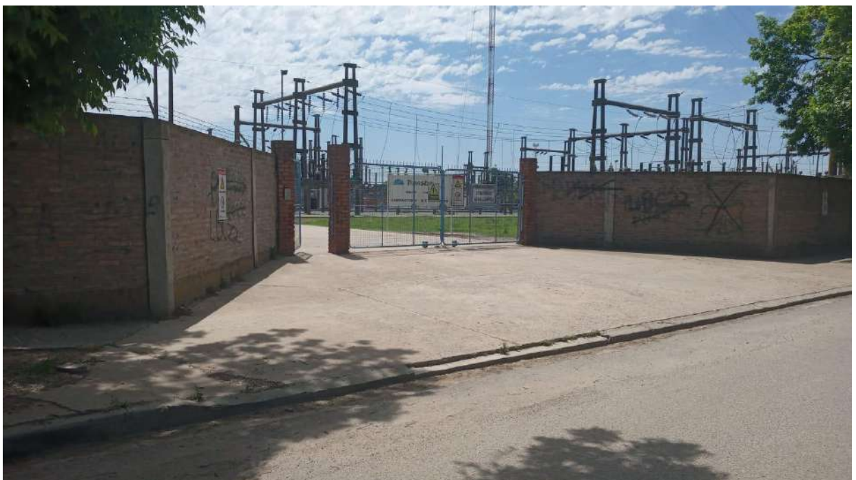
Fotografía 3 – Portón de ingreso a la EETT Mercedes – Amplio ingreso para la obra
