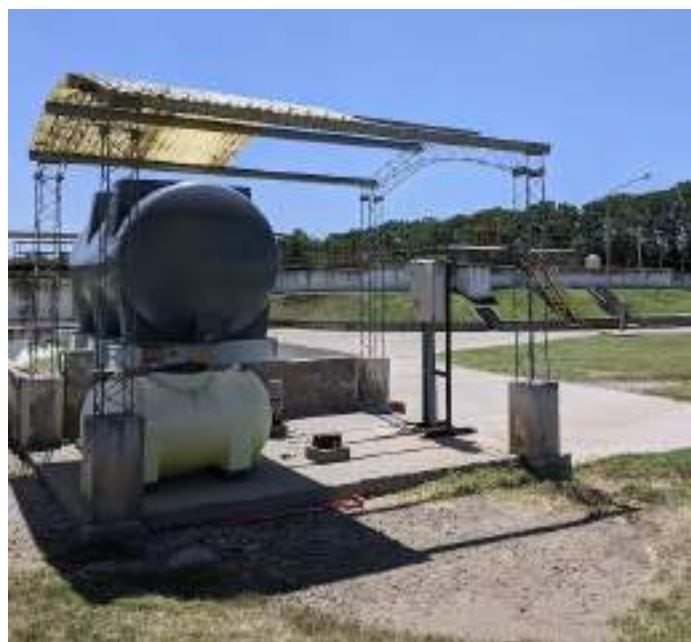
Figura 3: Cámara de Cloración.
