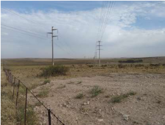
Electroductos existentes – Vista desde alambrado prop. Sr. Ruppel (hacia el norte)
