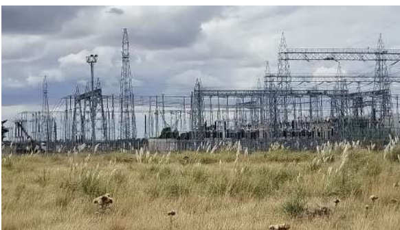
Acometida a pórticos 132 kv
