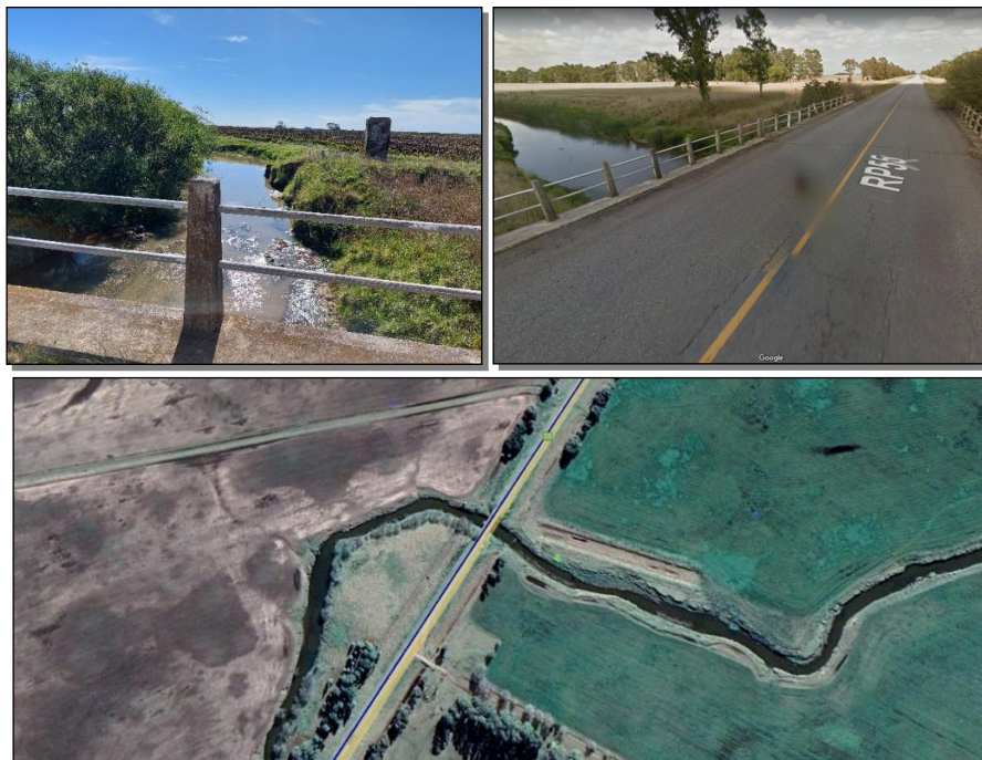
Figura 24. Cruce de la traza del Proyecto Acueducto Gliptodonte – General Pirán con el A° Grande y puente sobre Ruta Provincial 55.
