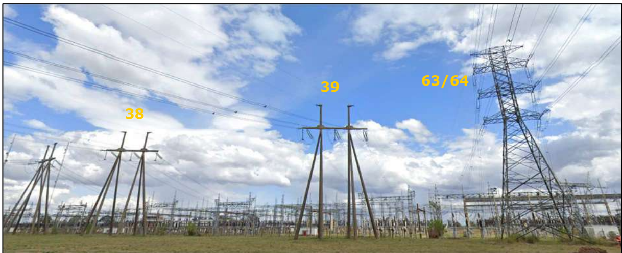
Gráfico 17. Torres terminales para LAT en 220 kV
