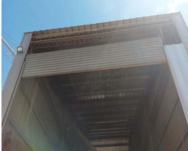
Imagen 1. Cortinas automáticas del área de descarga de camiones.
