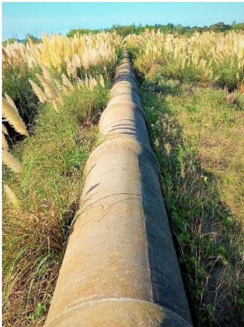
Fotografía 22. Canalización del efluente hacia el arroyo chico.
