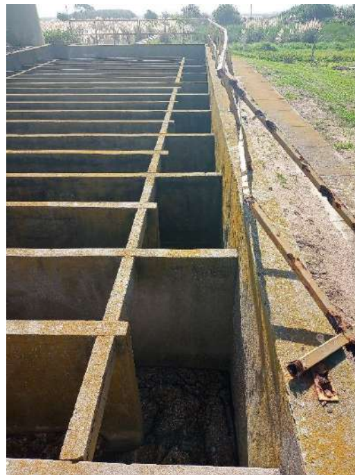
Fotografía 15. Cámara de contacto
