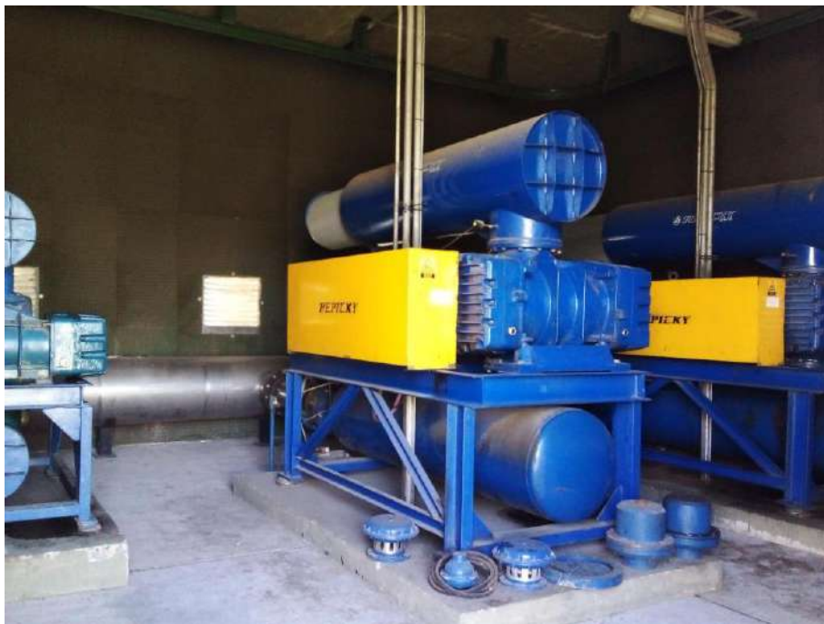
Fotografía 32. Sala de sopladores.
