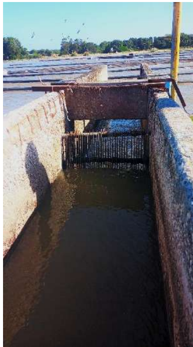
Fotografía 5. Ingreso al Reactor Aeróbico. Rejas gruesas
