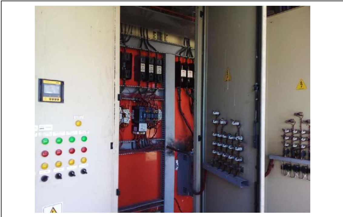
Fotografía 27. Tablero de control.
