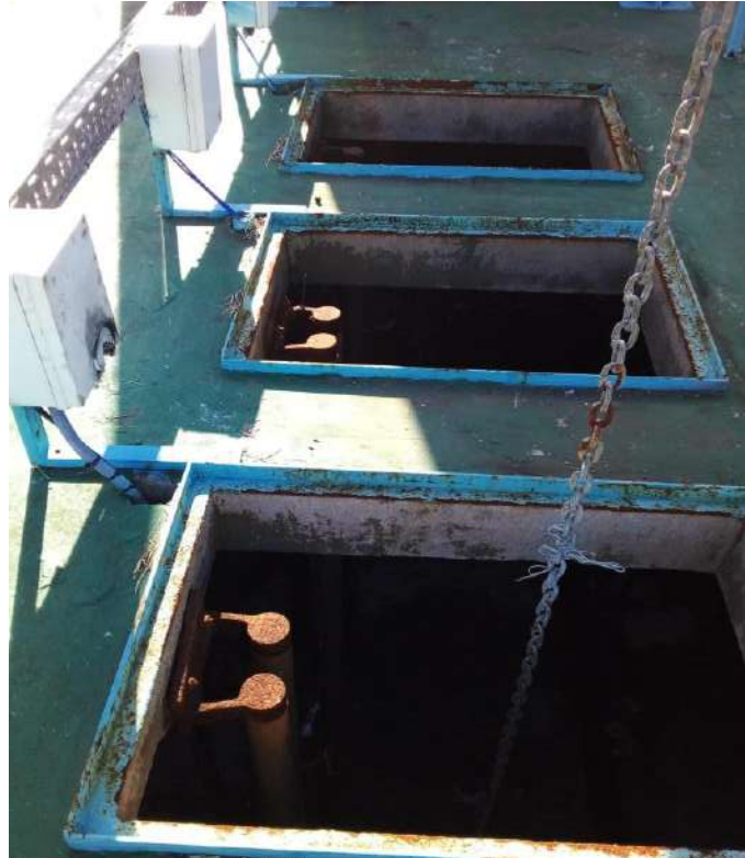
Fotografía 4. Pozos con rejas mecánicas de pre-tratamiento.
