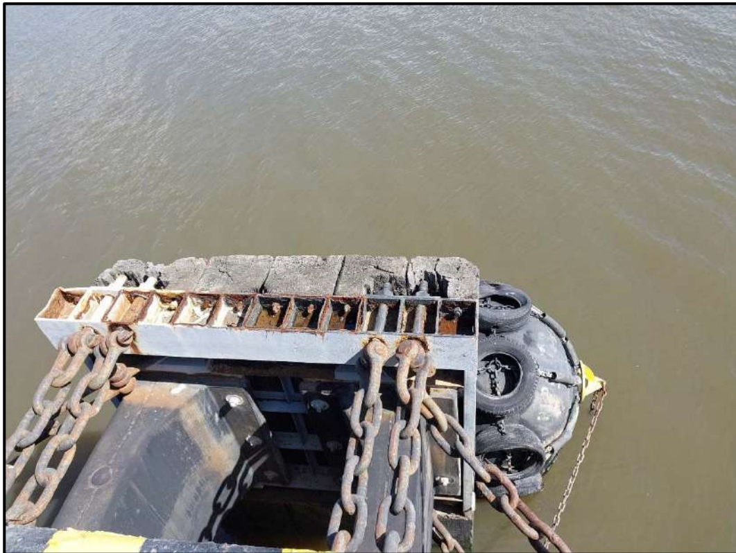
Fotografía N° 28 Vista desde arriba defensa Dolfin Norte 1 a ser reemplazado.
