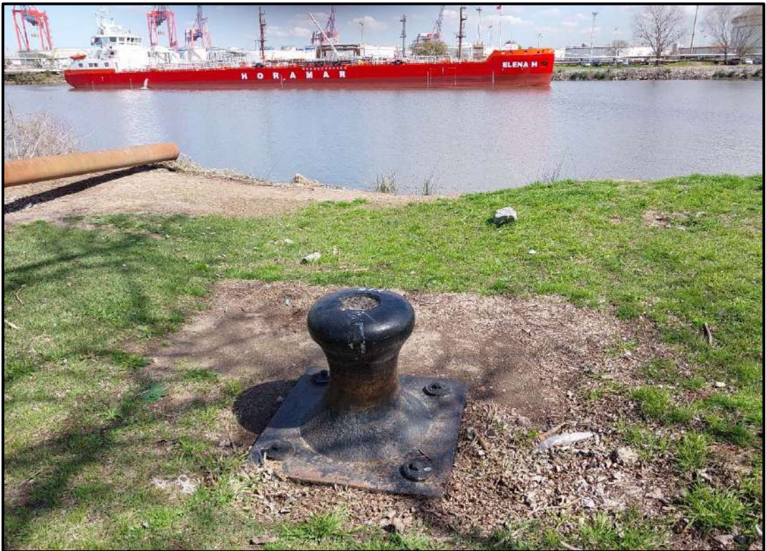
Fotografía N° 16 Bolardo fuera de servicio B7 a ser pintado.
