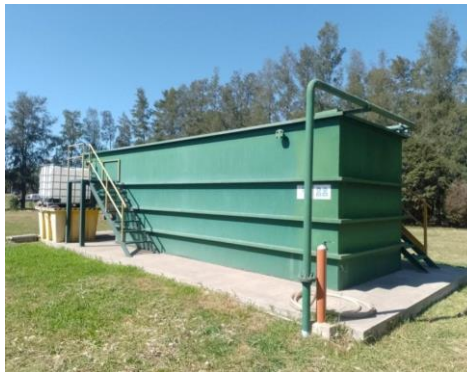
Figura N° 19. Planta de tratamiento de líquidos cloacales
