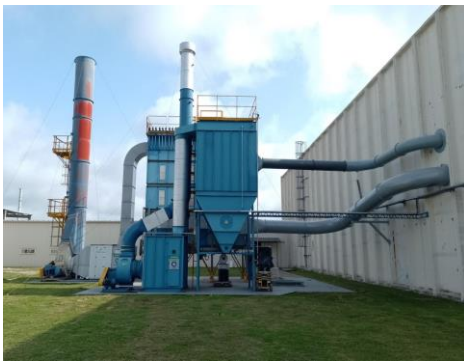
Figura N° 21. Filtros de mangas
