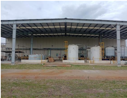
Figura N° 14. Sector tanques solución ácido sulfúrico
