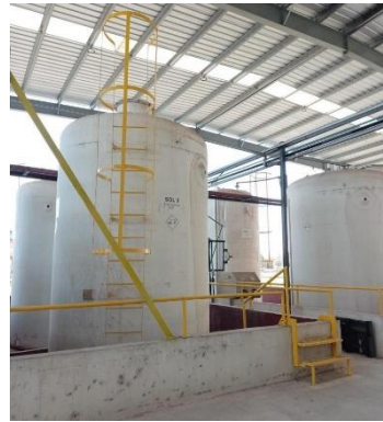
Figura N° 15. Tanques solución ácido sulfúrico
