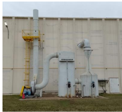
Figura N° 22. Lavador de gases Baterías Crudas
