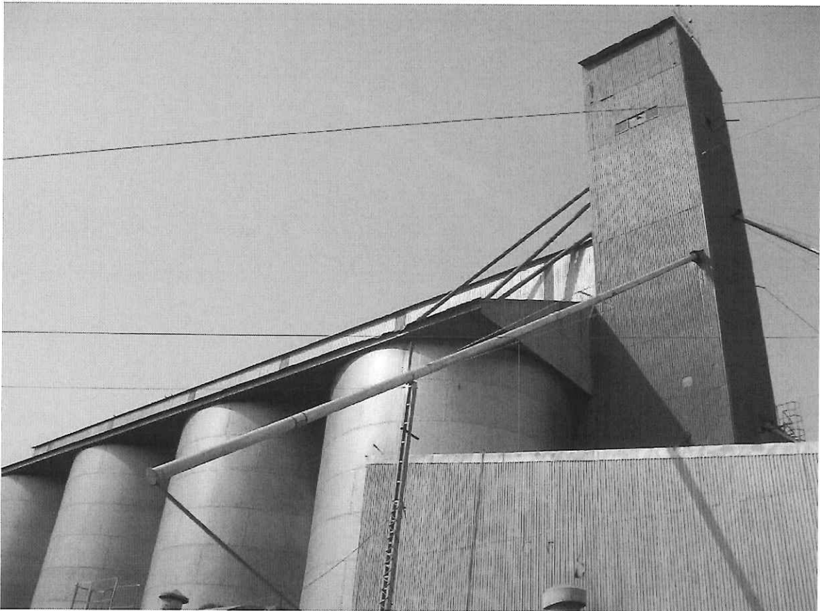
Detalle del cerramiento sobre el sistema de transporte interno de cereal
