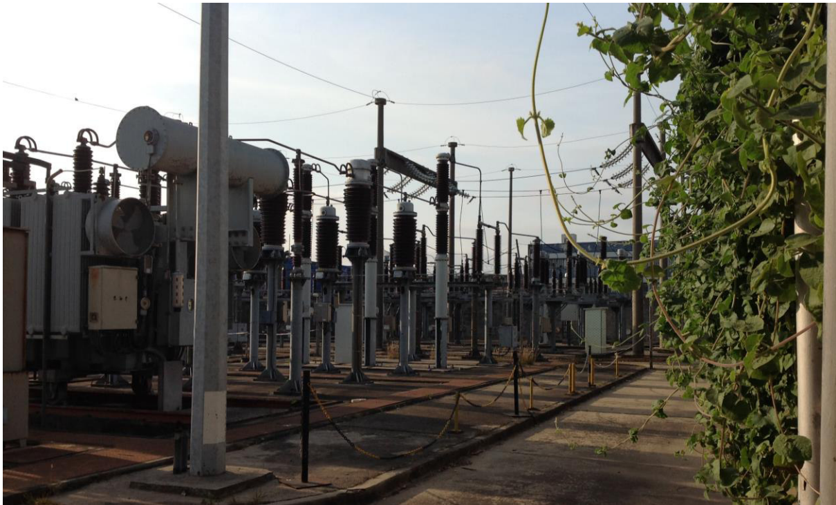
Figura 2.10 Estación transformadora compartida con Edenor para evacuar los excedentes en 132 kV. Foto de relevamiento.
