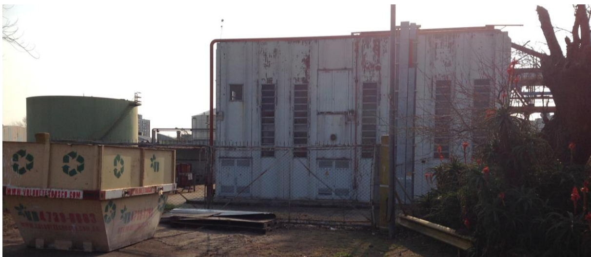
Figura 2.9 Subestación interna 13.2 kV adonde se conectará el PSP. Foto de relevamiento.
