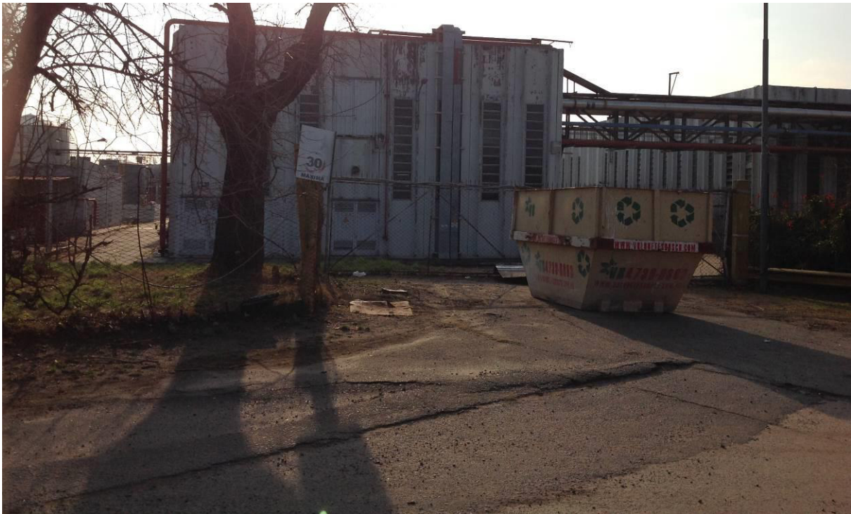
Figura 3.35 Subestación interna 13.2 kV, para pase de línea de media tensión.
