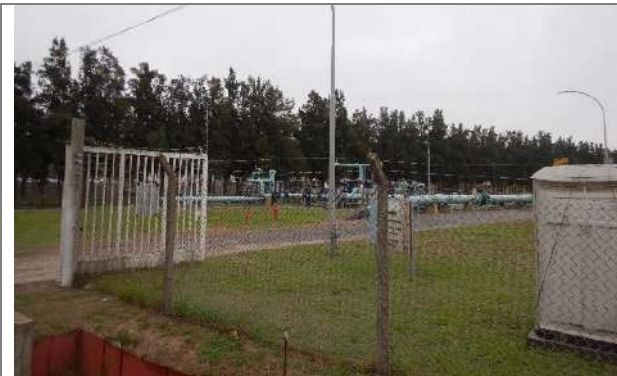
Foto 3.6-1. Entrada al sitio de inicio del Poliducto superficial dentro de la Terminal Campana de PAE. De fondo se observan Pinos ( Pinus halepensis ). 34° 10'8.12"S; 58° 56'38.77"O Dirección SO.
