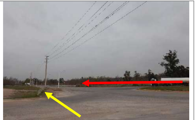
Foto 3.6-45. Alternativas de la traza por cada lado de la calle Alfredo Viola.
