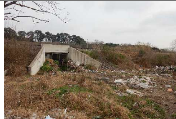
Foto 3.6-35. Ducto pluvial en zona de la traza del poliducto. Sector de basural a cielo abierto. 34° 10'30.16"S; 58° 56'14.68"O.
