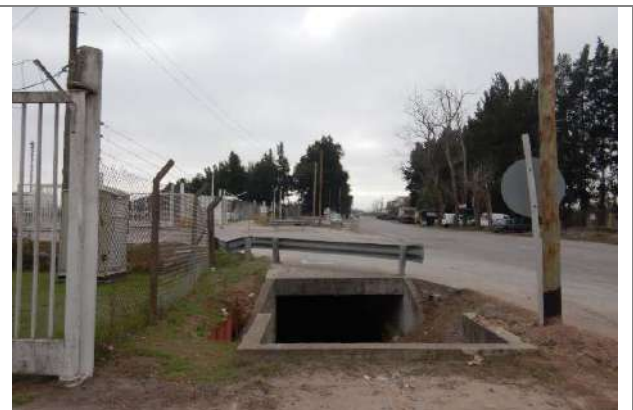
Foto 3.6-4. Interferencia de la traza del Poliducto con canaleta pluvial. 34° 10'8.45"S; 58° 56'39.08"O Dirección NE.
