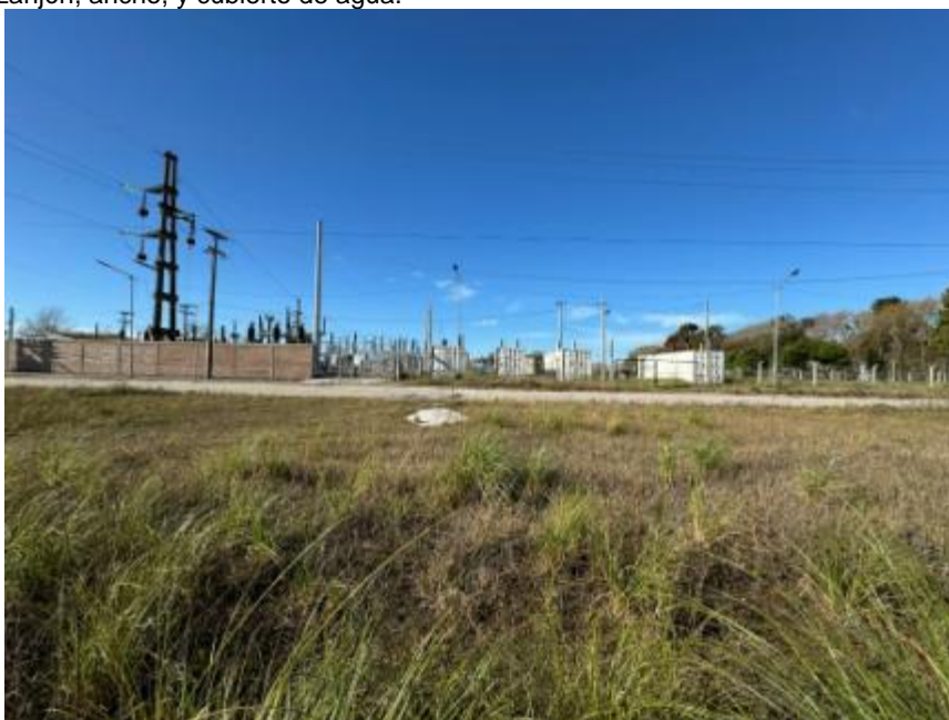
Foto 10. Tomada en el punto de la foto anterior, pero observando en sentido contrario. Se visualiza el frente sobre calle 16 de la manzana que ocupa la ET. Los cuatro contenedores blancos que se observan dentro, sobre el perímetro de la ET, son grupos electrógenos.
