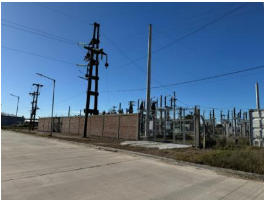
Foto 7: Tomada sobre la calle 16 donde se encuentra al portón principal de la ET Mar del Tuyú sobre esta calle, observándose el soporte doble de hormigón que sostiene la terna de 132 kV que hace el cruce de la Autovía, y que se visualiza en las fotos precedentes.
