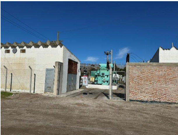
Foto 3.7. Vista, sobre calle 73, del portón de acceso a la zona activa de 132 kV, en la ET Mar del Tuyú que opera Transba S.A.
