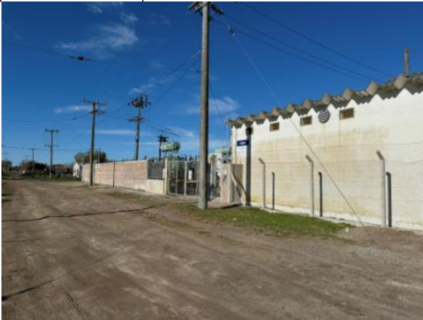
Foto 14. Tomada en el punto de la foto previa, observando hacia la esquina de calle 15 bis, se visualiza en primer plano la sala de celdas de EDEA, el paredón perimetral y diversas salidas de 13,2 kV aéreas, que alimentan el sistema de distribución de energía eléctrica de EDEA en el área.
