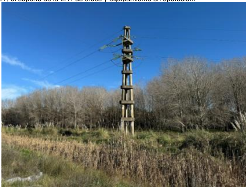
Foto 2. Tomada desde la banquina de la foto anterior, se observa el soporte triple desde donde sale actualmente la alimentación a la ET Mar del Tuyú. Se observa un zanjón de efluentes pluviales de unos 4 metros que corre entre el soporte de hormigón y la banquina de la ruta. La apertura para hacer la doble terna de vinculación se efectuará a unos metros al sur (hacia MDQ) de este soporte.
