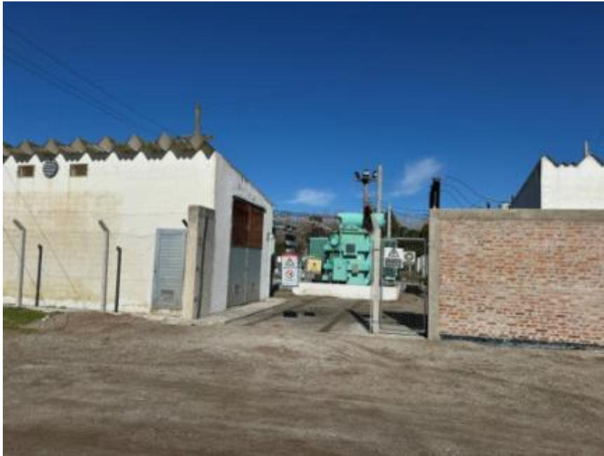
Foto 13. Tomada a 25 metros de la esquina de 16, permite observar a través del portón de acceso, el transformador de 132/33/13,2 kV, de 20/20/6,6 MVA operado por TRANSBA. Sobre la izquierda la sala de celdas de EDEA.
