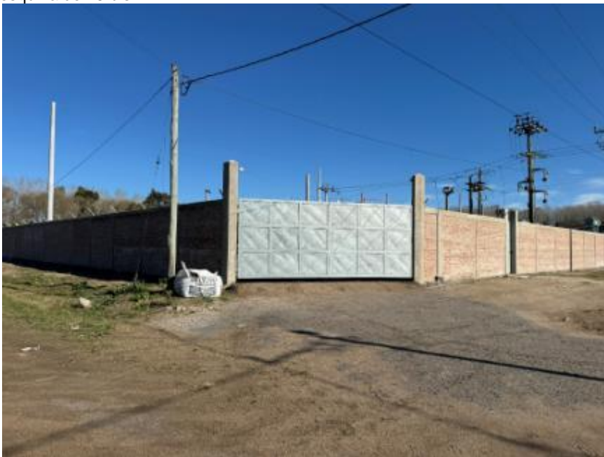
Foto 16. Tomada sobre la esquina de 73 y 15 bis, observando la ochava, donde se encuentra instalado un ancho portón nuevo, en el encuentro de los paredones de ladrillo, también de reciente construcción.
