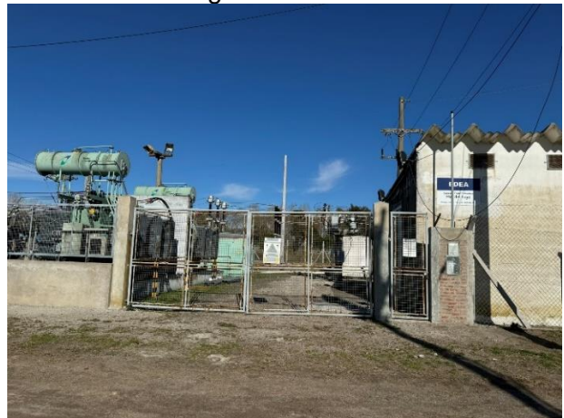
Foto 3.8. Vista del portón de acceso al área activa, en media tensión, de la ET sobre calle 73, en el sector operado por EDEA.
