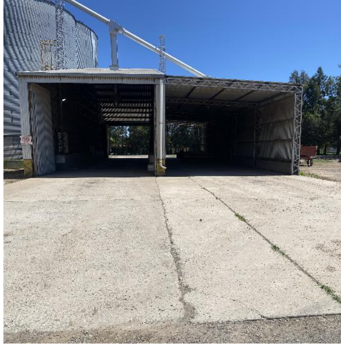
Imagen 11: Vista general de Descarga 1 con sector cerrado aledaño para Carga de Camiones
