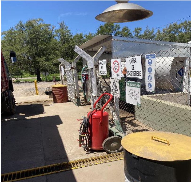
Imagen 15: Sector de carga/descarga de combustibles líquidos (gasoil)
