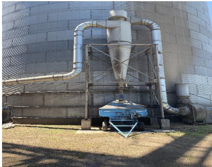
Imagen 9: Vista de separador de polvo con colecta en acoplado cerrado
