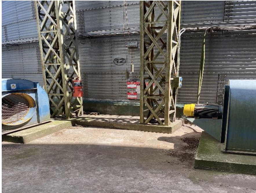
Imagen 7: Aireadores de silos
