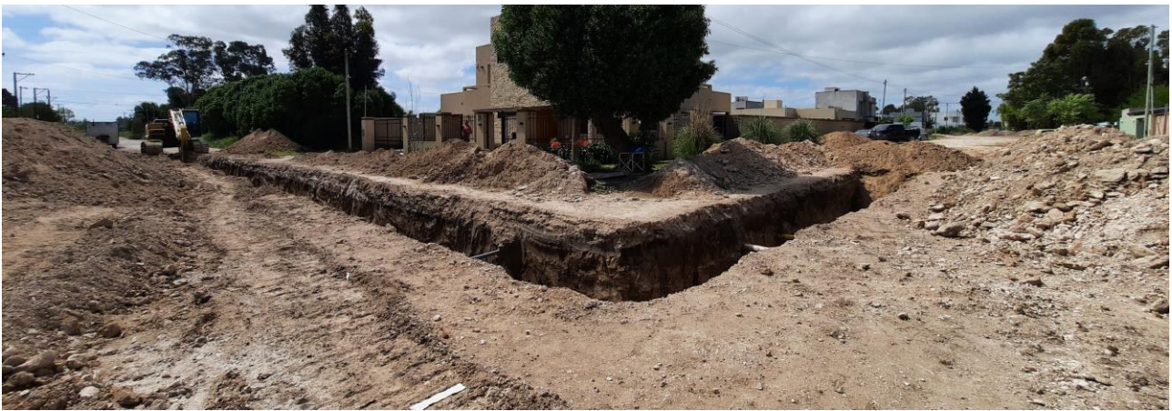
Figura 9: zona de obra, el acceso a la vivienda se encuentra limitado. Los vehículos deben estacionar fuera de la zona de obra.
