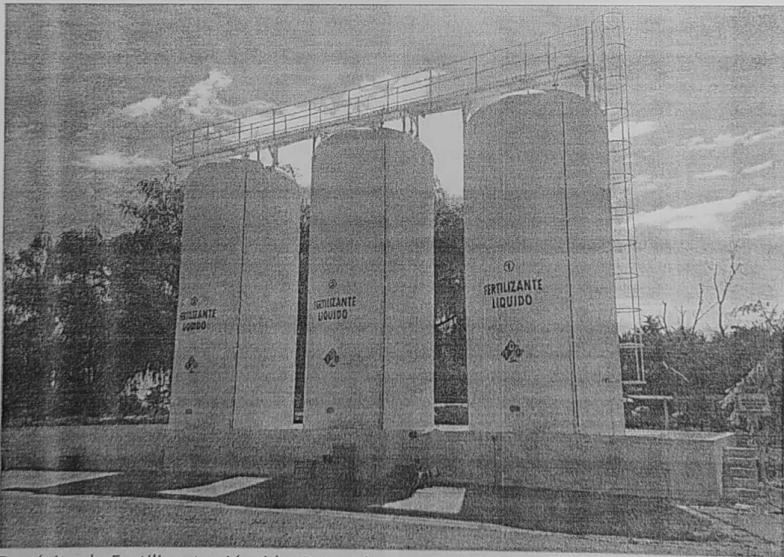
Depósito de Fertilizantes Líquido. Batea de contención de derrames.
